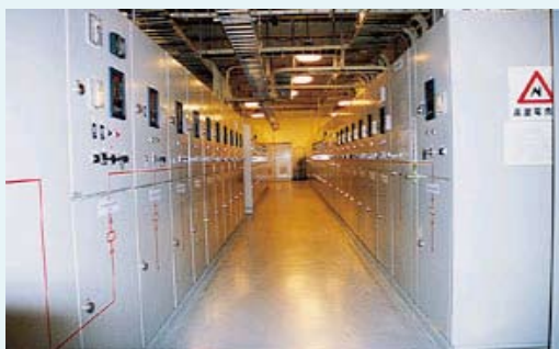
高低壓配電盤
