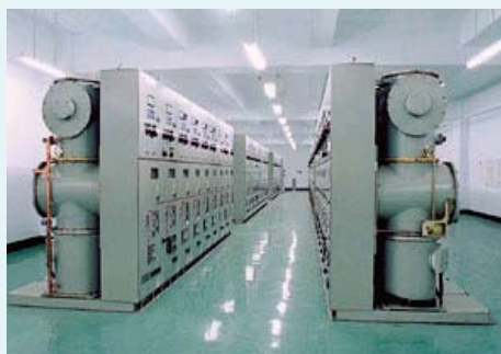
23 ~ 161 kV GIS 設備
