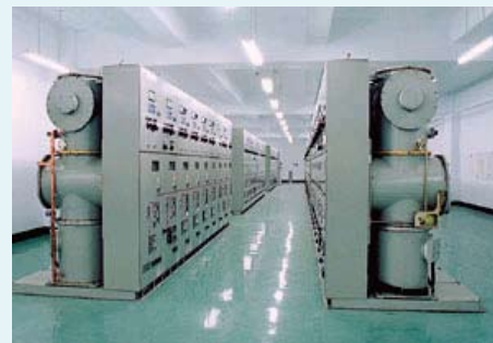
23 ~161 kV GIS 設備
