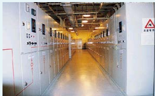
高低壓配電盤
